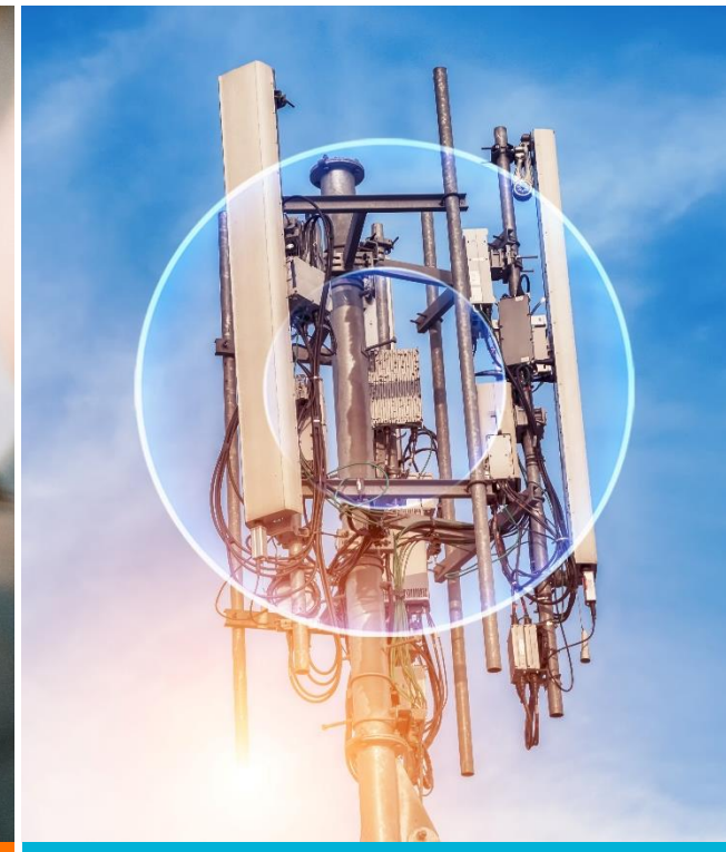
通信基础设施
